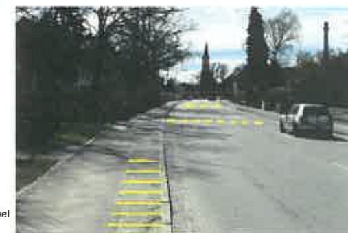
Fehlende Querungsmöglichkeiten und beschädigte Oberflächen
